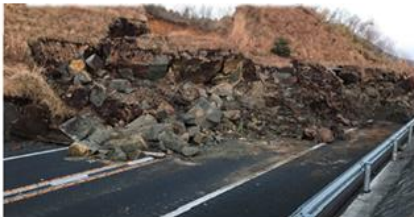
図ー4 地震による高速道路法面崩壊状況
