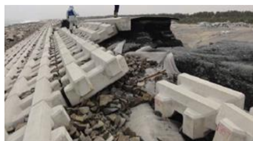
図－2 ブロックの崩壊
