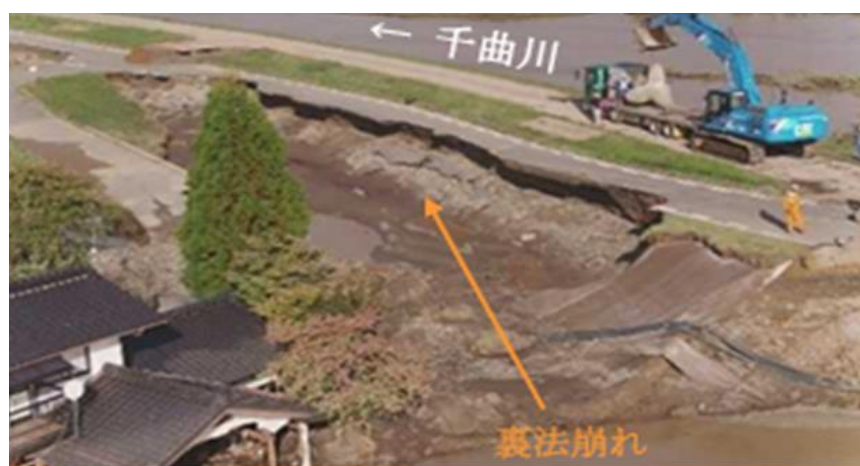
図－3 裏法面部が侵食され崩壊した状況
